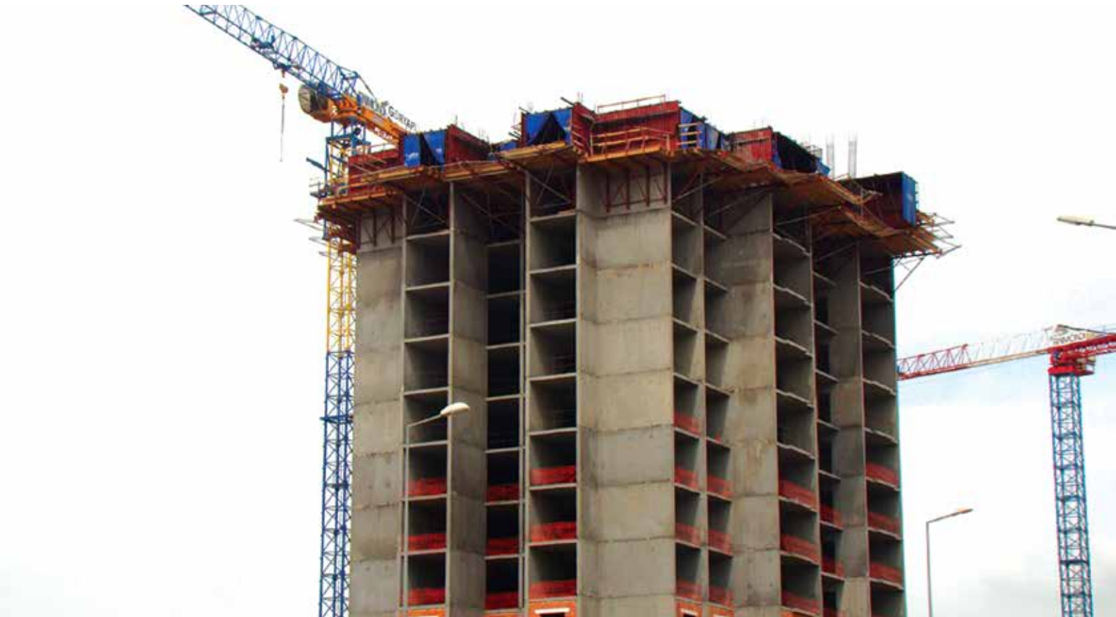
GÜRYAPI - İstanbul Metrokent Konutları / Istanbul Metrokent Houses
